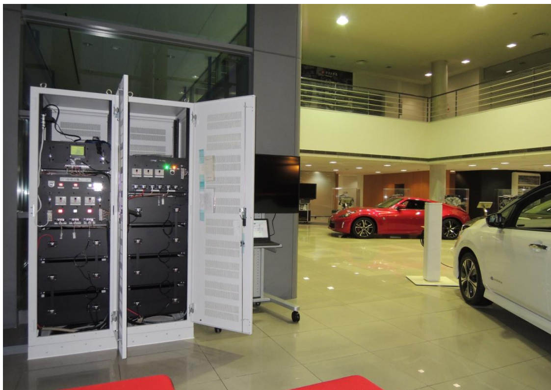
太陽光パネル 10kW、蓄電池容量 40kWh
