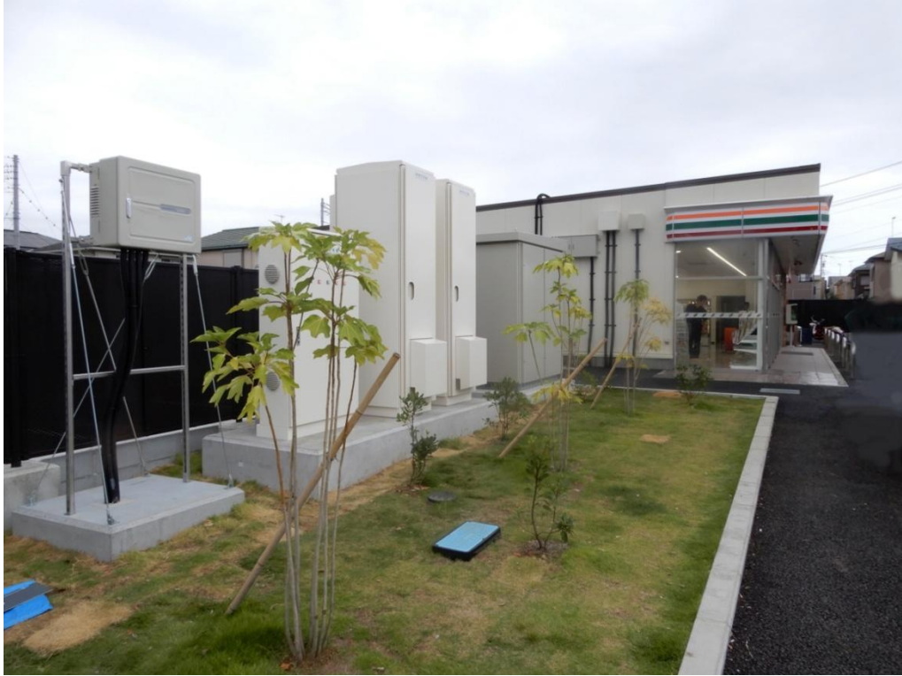
太陽光パネル 28kW、蓄電池容量 80kWh
