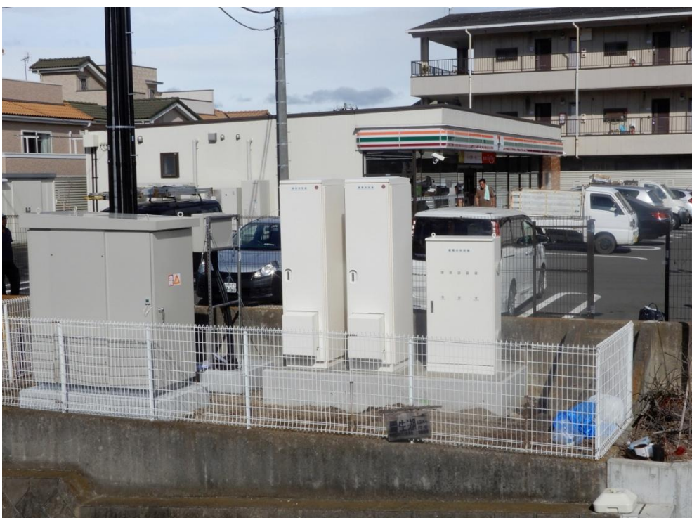
太陽光パネル 28kW、蓄電池容量 80kWh
