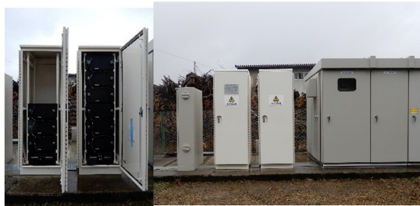
蓄電池ユニット&制御装置 (株エジソンパワー製)
